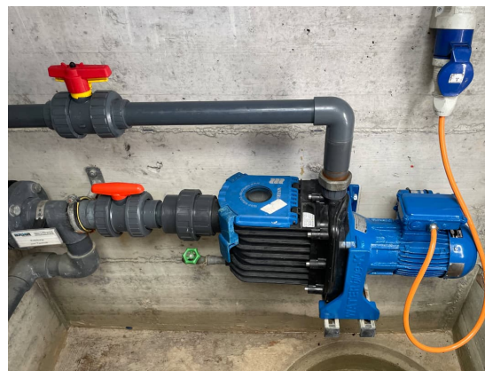
Bild 37: Aufstellung Attraktionspumpe, sichtbar ist ein kleiner Pumpensumpf unten rechts
