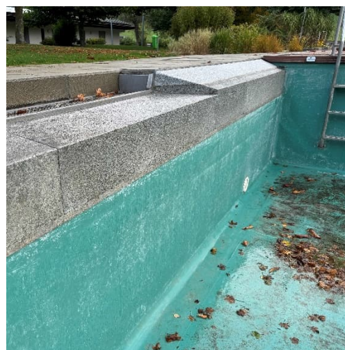
Bild 25: Bestehende Folienauskleidung und Rinne
