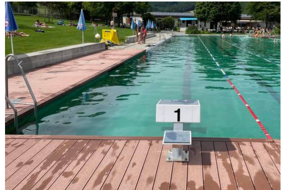
Bild 14: Rinne unter dem Holzrost, nicht zugänglich
